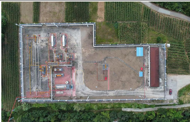
元坝 10-C1 集气站现场照片
